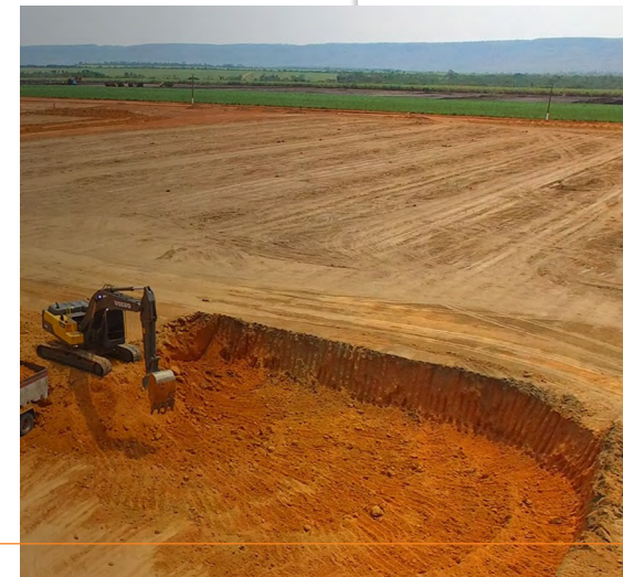
UISA GEO BIOGAS
